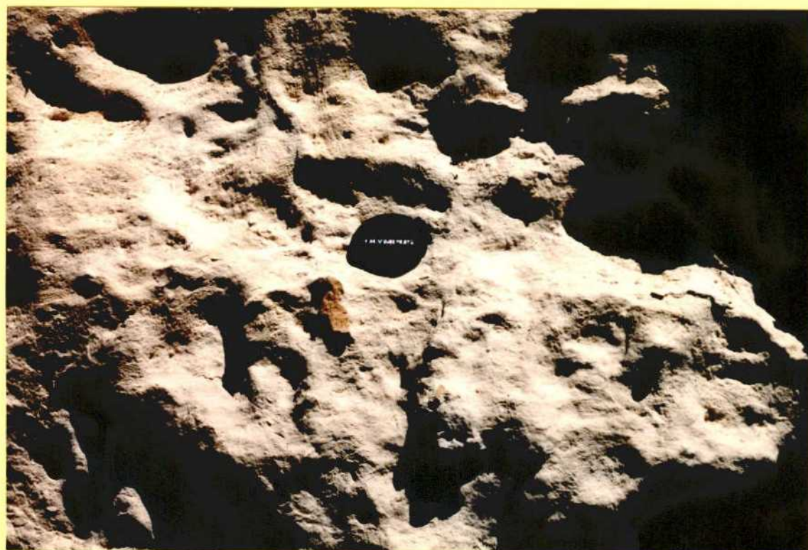
Alteración superficial de las calizas.
